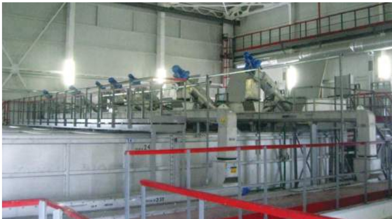
Цех механической очистки
