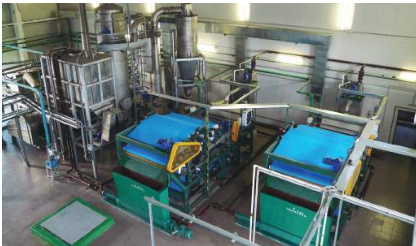
Ленточные фильтр-прессы производства ТПП «Экополимер»
